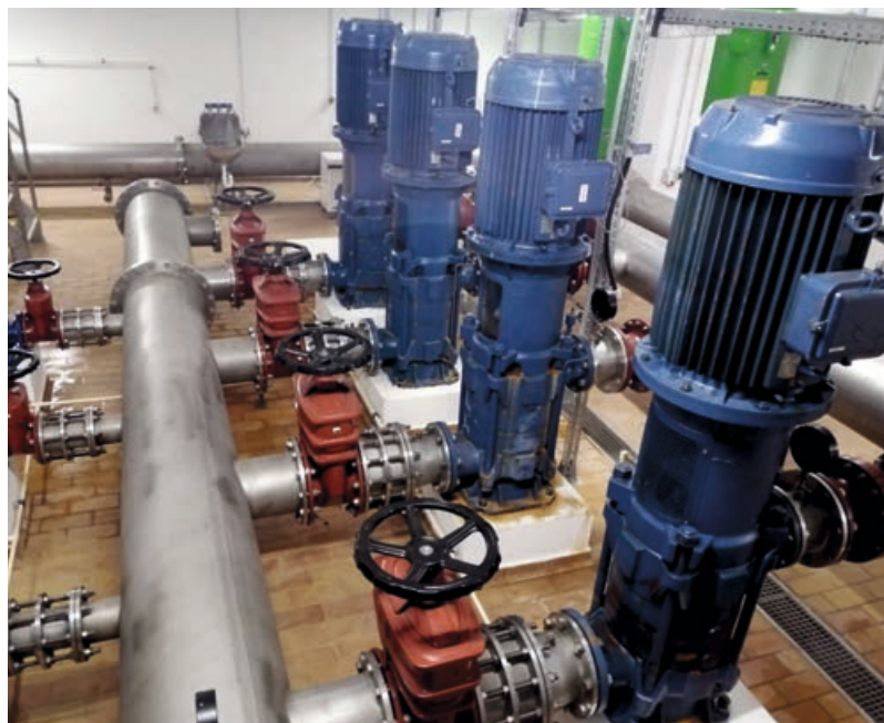
Die Druckerhöhungsanlage Großenhain-West vor dem Umbau.
