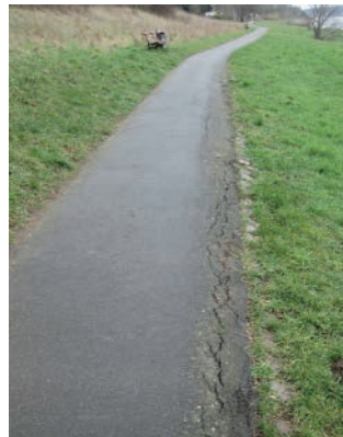
Abgängiger Randstreifen vor Baubeginn
